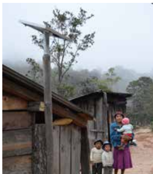
Sistema Fotovoltaico Domiciliario instalado en la Comunidad La Talera, municipio San Pedro y San Pablo Ayutla, Sierra Mixe
